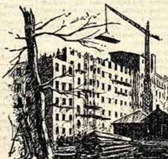
Москва. На Верхней Масловке возводится новое 7-этажное здание. Здесь художники получат квартиры с мастерскими.
