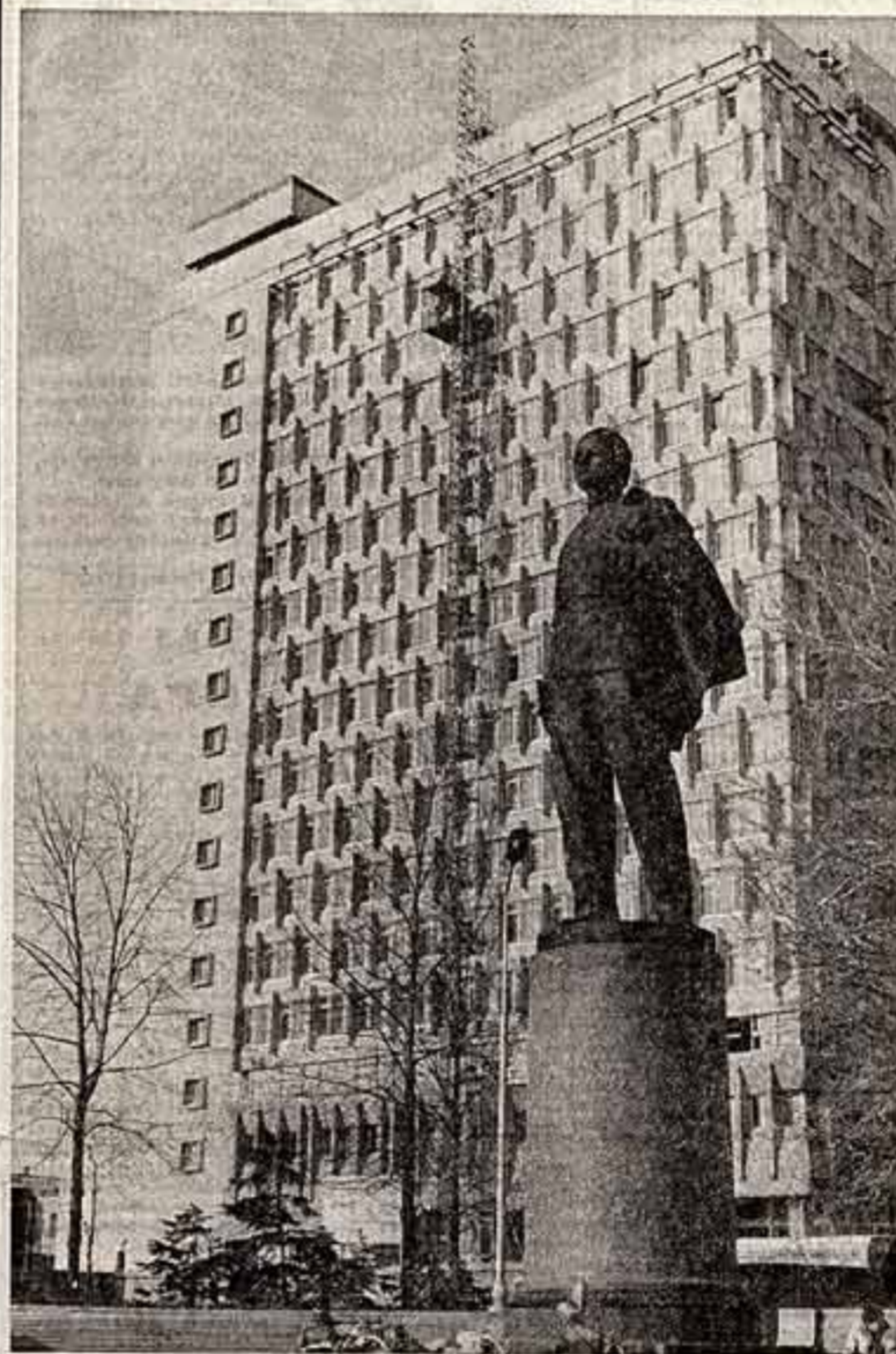
Продолжает строиться Казанский государственный университет им. Ульянова-Ленина. Уже идут занятия в новом здании естественных факультетов, заканчивается возведение корпуса гуманитарных факультетов. Фото И. Бергольцева.
