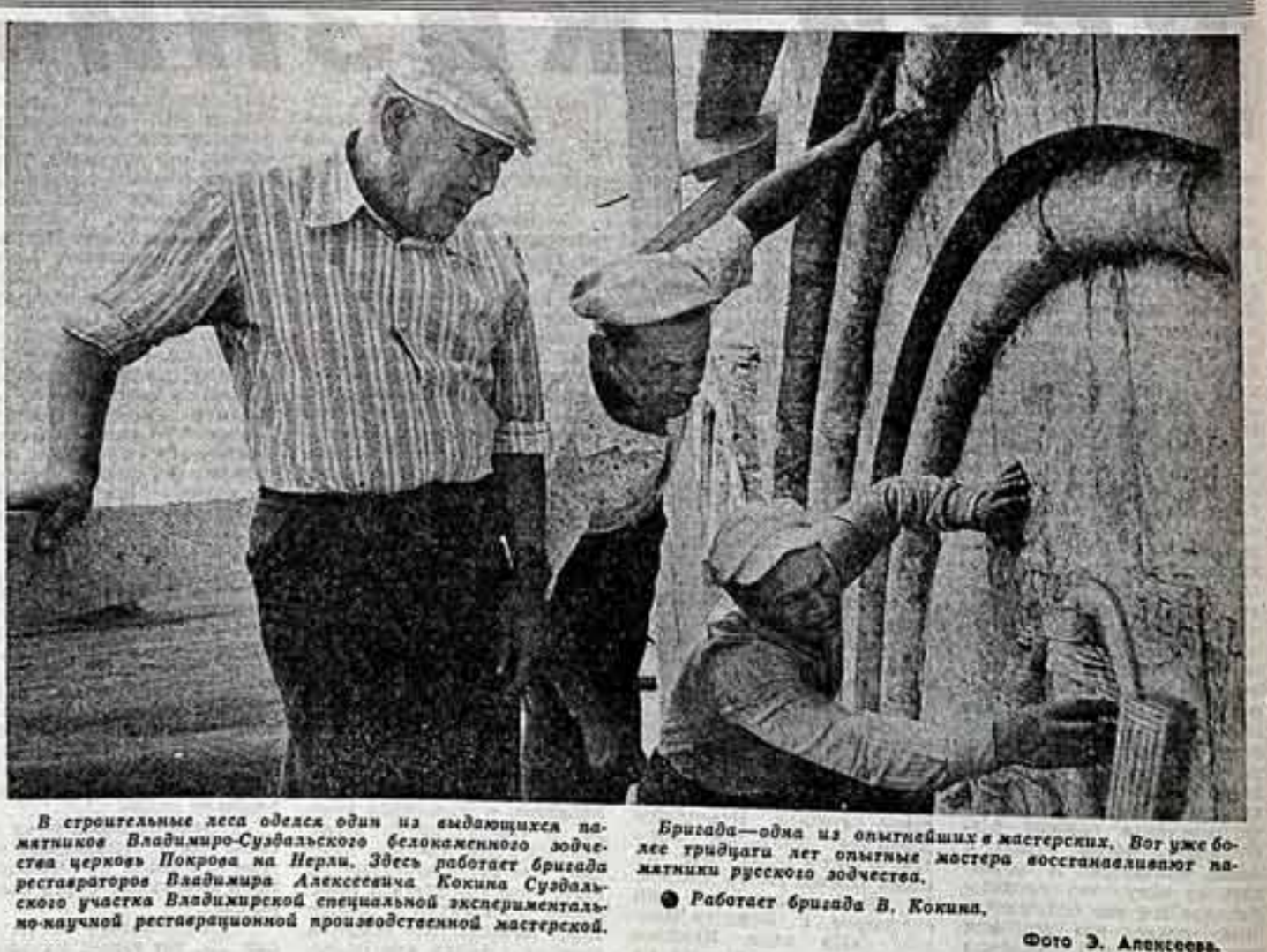
В строительных лесах обделал один из выходящих памятников Владимира Суздальского белокаменного зодчества церковь Покрова на Нерли. Здесь работает бригада реставраторов Владимира Алексеевича Кожина...
